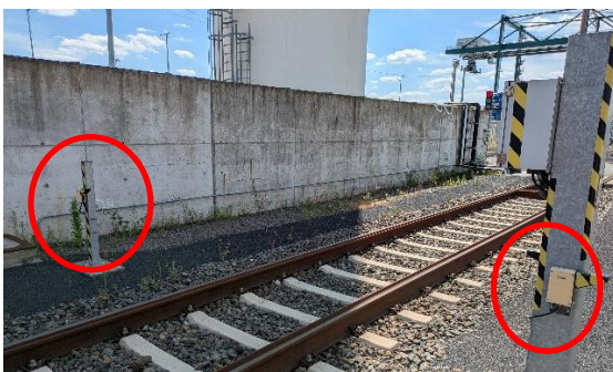
Lichtschranke Gleis 3 (4+5+6 ähnlich)
